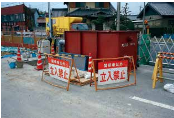
ノッチタンクの設置状況
