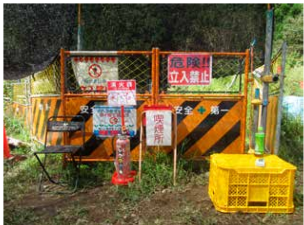
吸殻入・消火器設置状況
