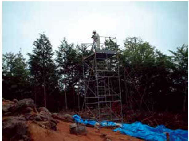
ローリングタワー
