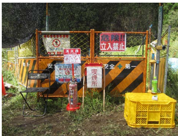
吸殻入・消火器設置状況
