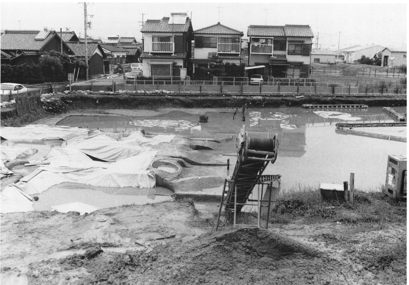
水没したC区
