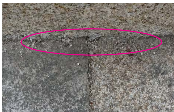
図6 真砂土化によって剥落した鈷物(北から撮影)
