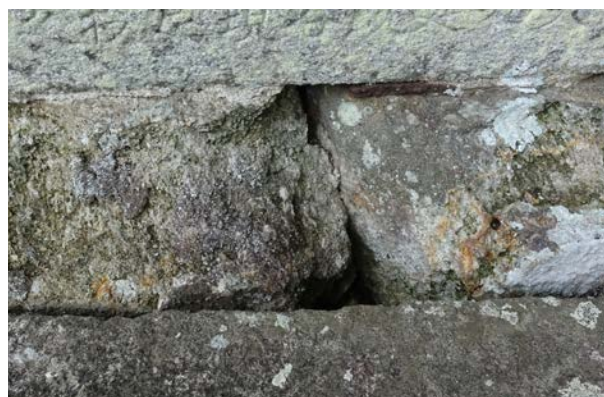
図18 基壇の劣化の様子(東から撮影)
