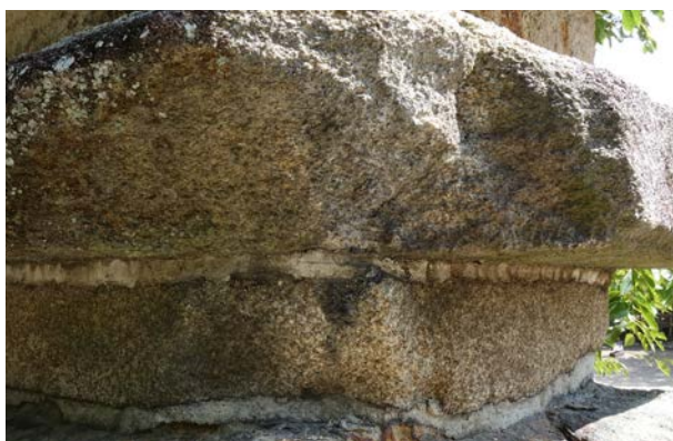
図17 三層軸と笠の劣化の様子(南西から撮影)
