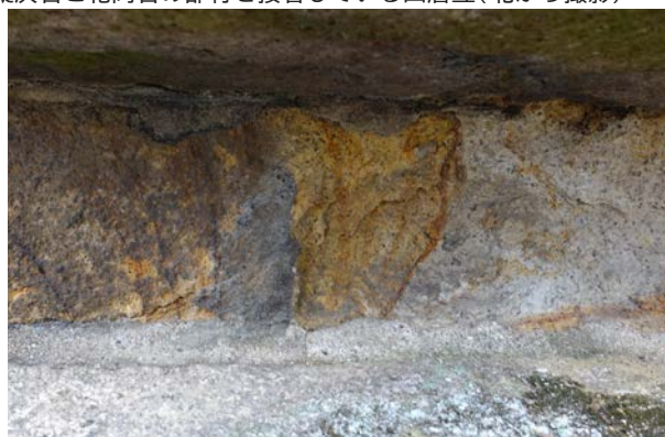
図5 二層軸の劣化の様子(西から撮影)
