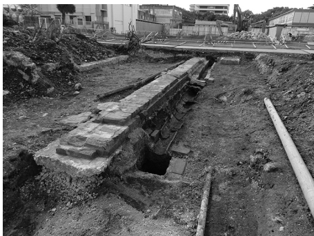
25Ah区 愛知一中校舎基礎 渡り廊下脇の雨落ち部 (東より)
