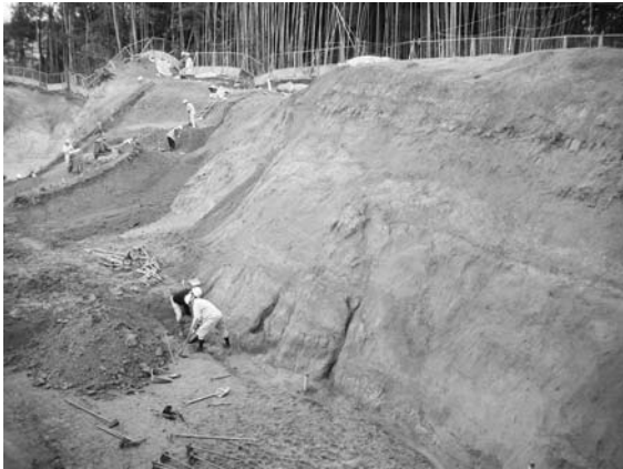
北の堀 崩落部分
