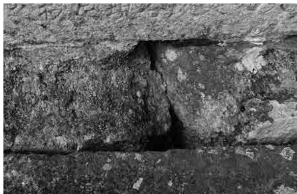
図18 基壇の劣化の様子(東から撮影)
