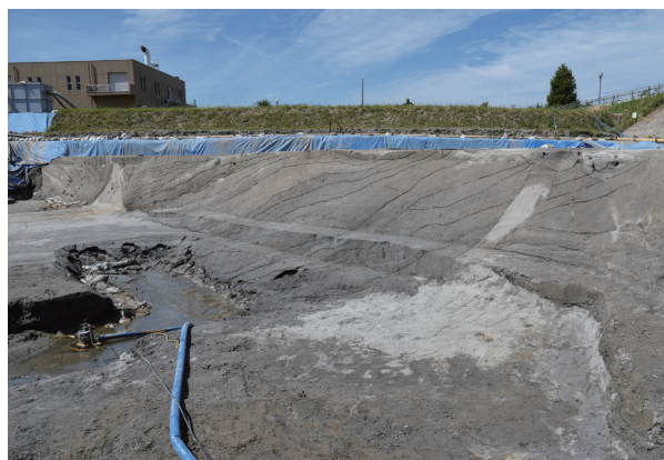
19区 400NR 左岸部の側方堆積 (西より)
